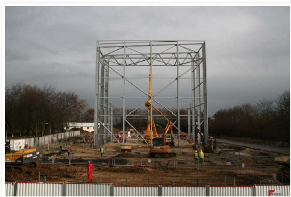
Fig. 3. Le nouveau magasin pour le stockage de journaux (NSB) en cours de construction à Boston Spa
