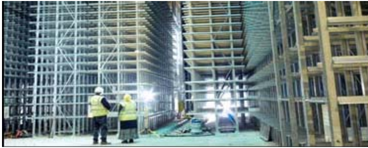
Fig2A. Stockage à haute densité, Bâtiment 31
